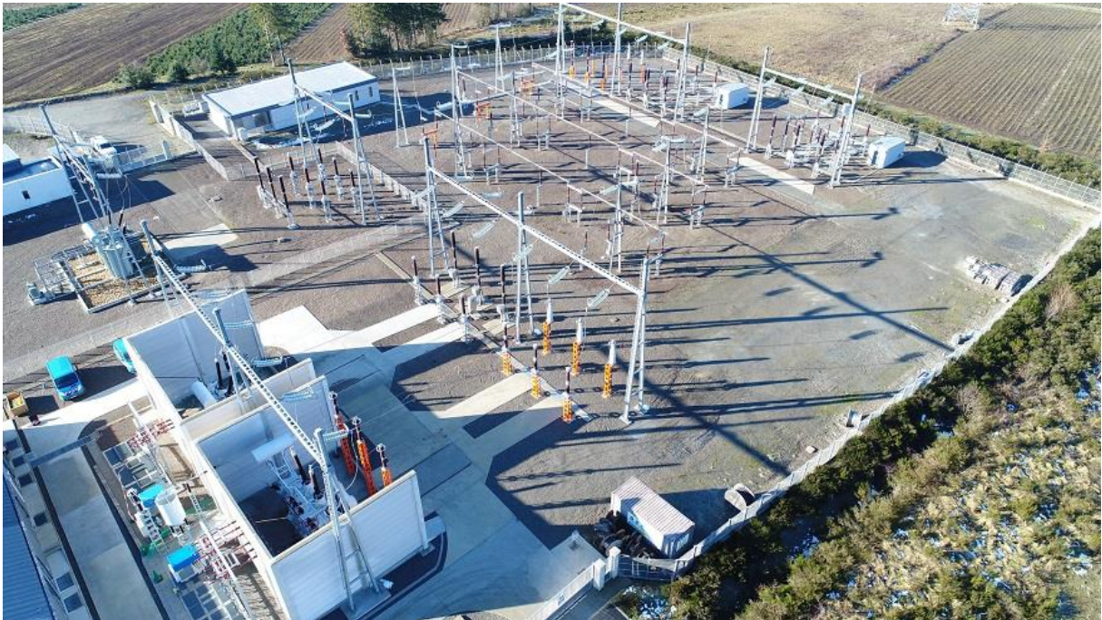
Vue d'un poste source électrique
